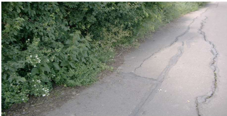
Abbildung 59: Oberflächenschäden im Ausbaubereich. Foto: Weinkopf
